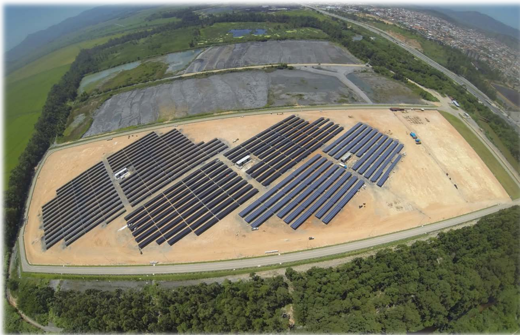
Usina Cidade Azul – 3 MWp – Santa Catarina
