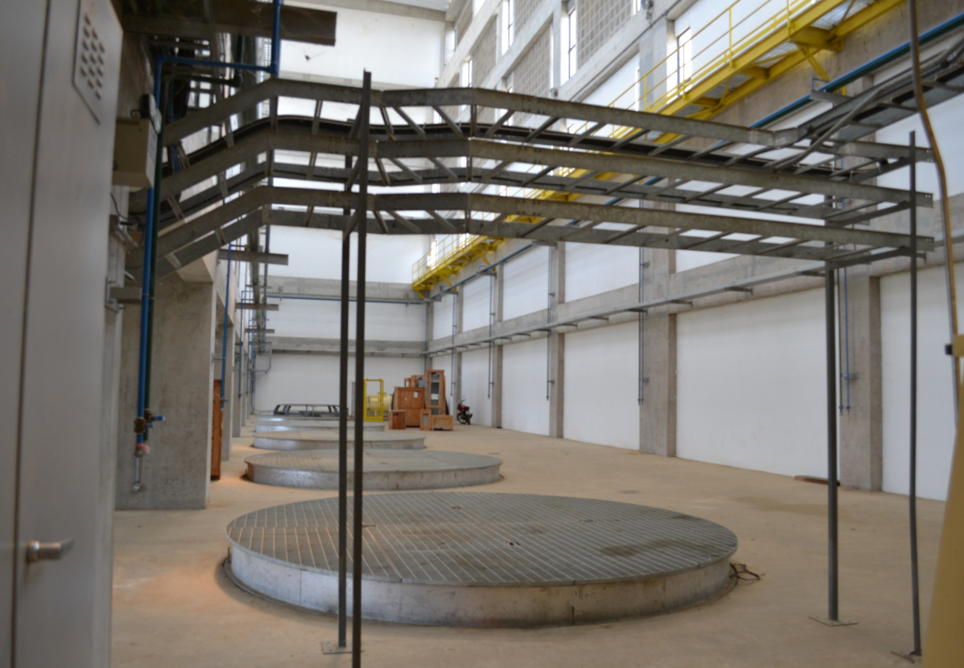
Local de instalação dos demais conjuntos motobomba
